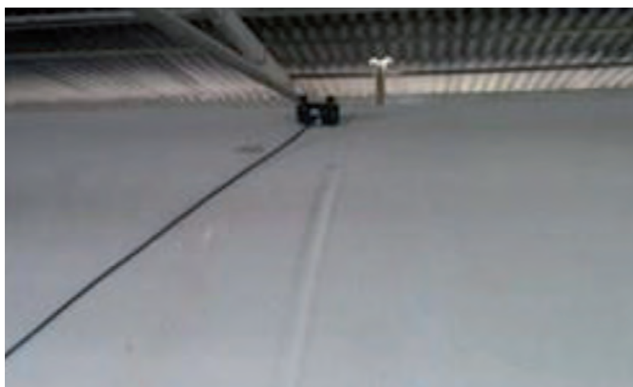
Uno de los seis sensores AE en un gran depósito de almacenaje
